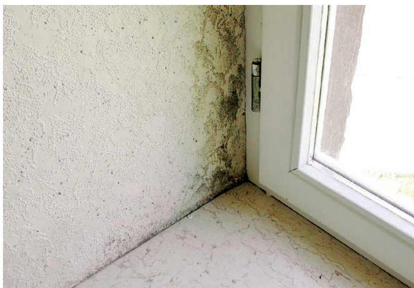
Obr. 1: Plíseň je v okolí napojení okna k ostění je nejčastěji důsledek nesprávně provedené připojovací spáry, která je netěsná a špatně tepelně izoluje.
